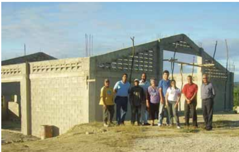
El Ingeniero Santiago Rivas supervisa la construcción del Centro de Acopio conjuntamente con los miembros de la Asociación de Apicultores "La Fronteriza".
